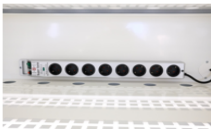
8-vägs grenuttag ovanför perforerad hylla.
